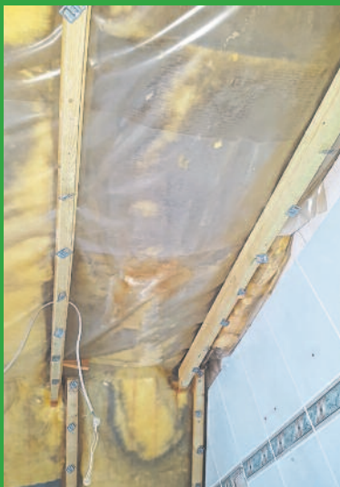
Abbildung: Wasserdampfschäden in der Dachdämmung eines Bades durch eine nicht fachgerecht angebrachte Dampfbremse.
